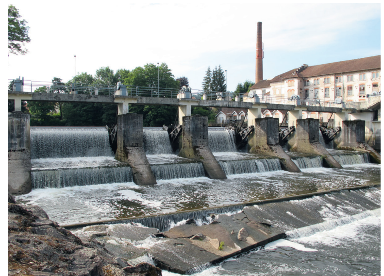
Centrale hydroélectrique de Saint-Laurent à Epinal - © Terr'EnR
