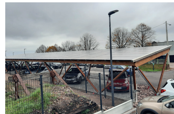
Ombrière photovoltaïque de la Maison de l'Habitat et du Territoire - © Terr'EnR
